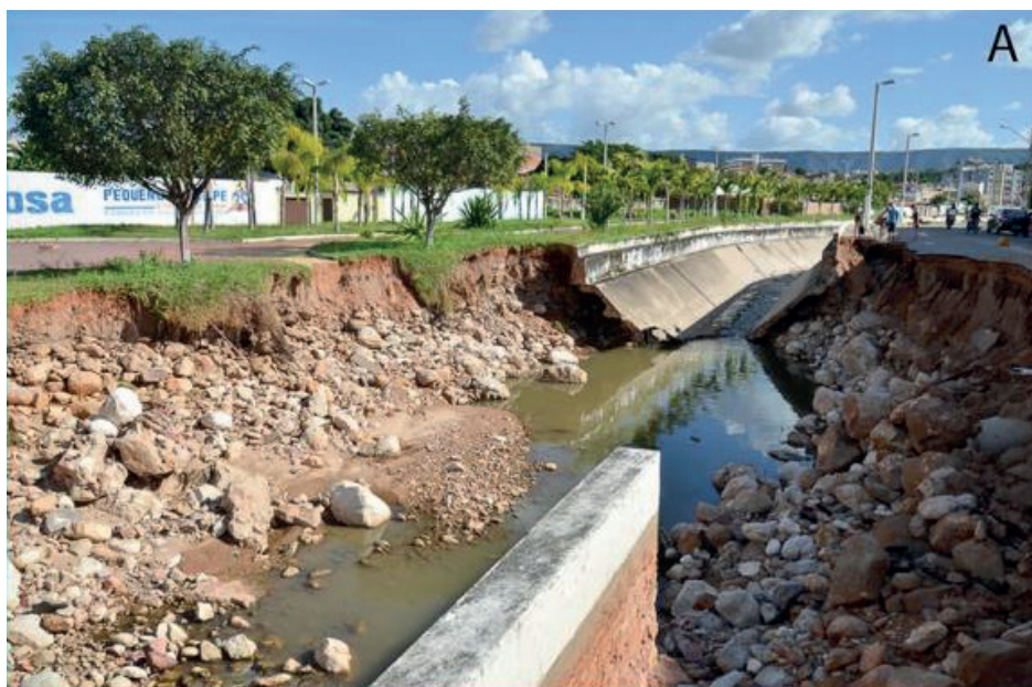
Ілюстрація 52: зруйноване штучне берегове укріплення (Бразилія)
